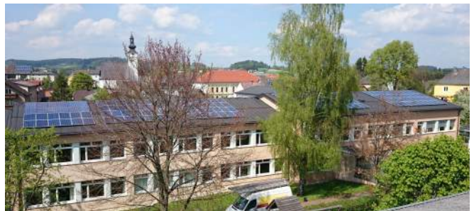
Photovoltaikanlage auf der Hauptschule
