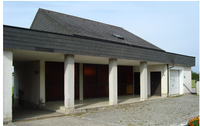
Die Aufbahrungshalle ist nach fast 35 Jahren innen und außen samt WC-Anlage einigermaßen sanierungsbedürftig.
