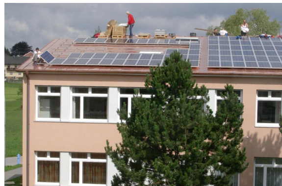
Strom aus Sonnen-Energie wird auf dem Hauptschuldach erzeugt. Beim Schuleingang können jederzeit die momentane Leistung und die erzeugten kWh abgelesen werden.
