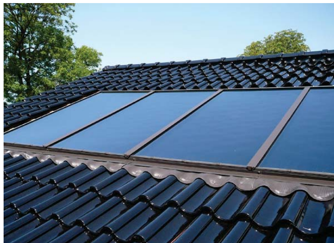
Eine Solaranlage produziert umweltfreundlich Warmwasser
