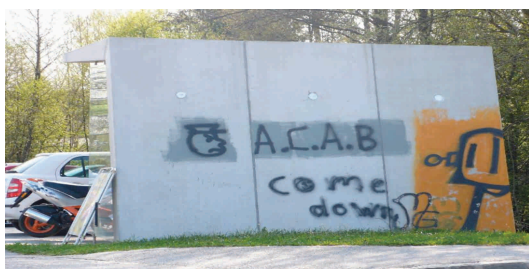
Vandalismus (Besprühen) an einem Wartehäuschen beim Parkplatz in der Böhmerwaldstraße.
