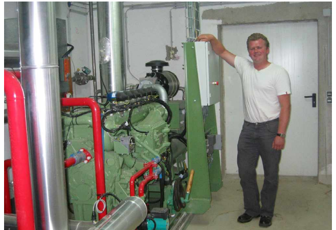
Firmeninhaber Ing. Wolfgang Hofer (am Foto neben dem Stromgenerator der Anlage) konnte seine Biogasanlage Mitte April in Betrieb nehmen.
