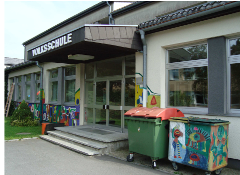
Die Sanierung der Volksschule war vom Land für etwa 2012 avisiert, begonnen wird aber erst, wenn der Zeitraum für die Landesmittel wirklich fix zugesagt wird. Eine Vorfinanzierung würde die Gemeindefinanzen überfordern, auch wenn das Zinsniveau derzeit niedrig ist. Schließlich kostet die Sanierung über eine Million Euro.
