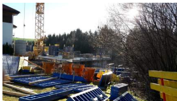
Mit dem Zu- und Umbau samt Generalsanierung gehört das Bezirksaltenheim Lembach zu den Großbaustellen im Bezirk. 10,5 Mill. Euro werden in die stationäre Seniorenbetreuung investiert, womit dann alle 6 Altenheime modernsten Standard aufweisen.
